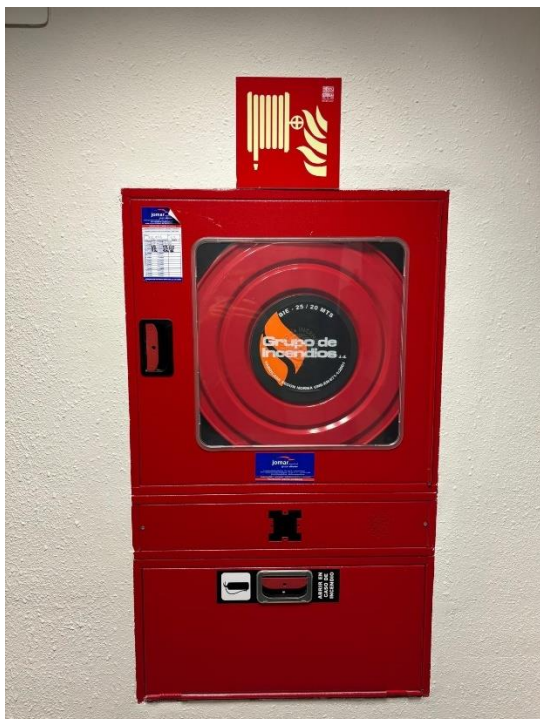
Exemple de conjunt BIE, extintor hídric i polsador
