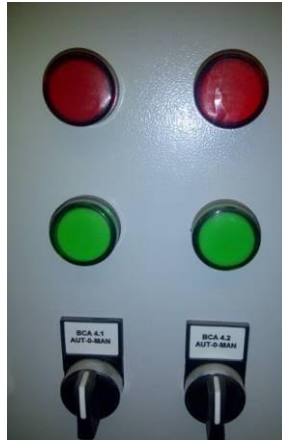
Exemple elements de maniobra i informació quadre elèctric climatització
